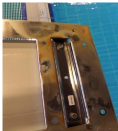
OSB mal entretenu
